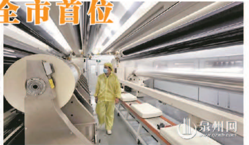
泉州嘉德利電子材料有限公司技改後的車間
